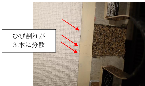
写真1 ひび割れ分散性の確認実験
