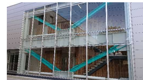
2 増築棟 制震ダンパー
