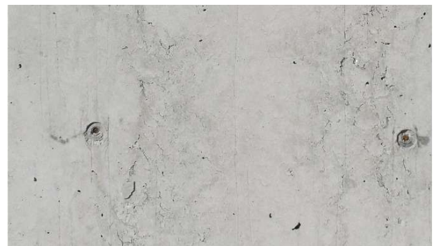
写真-3 表層変状 (砂すじの例)
