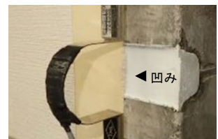
写真 1-5 シーリングの凹み
