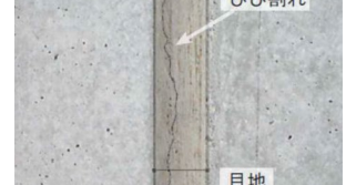
写真 1-3 同左 ひび割れ誘導
