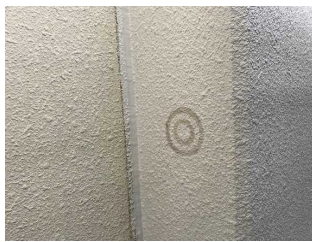
写真-5 汚れの付着状況
