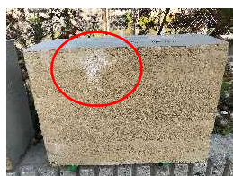
写真－6 暴露3ヶ月後（けい酸塩系含浸材塗布）
