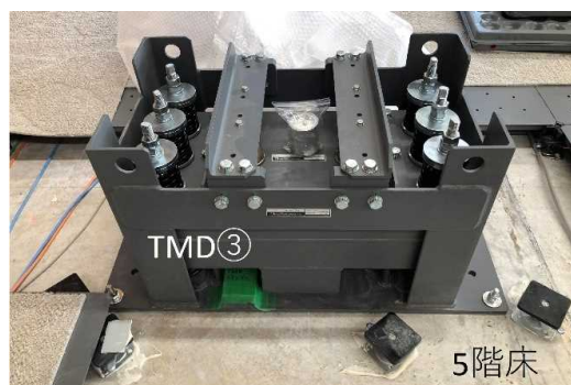
写真 4 TMD③の設置状況
