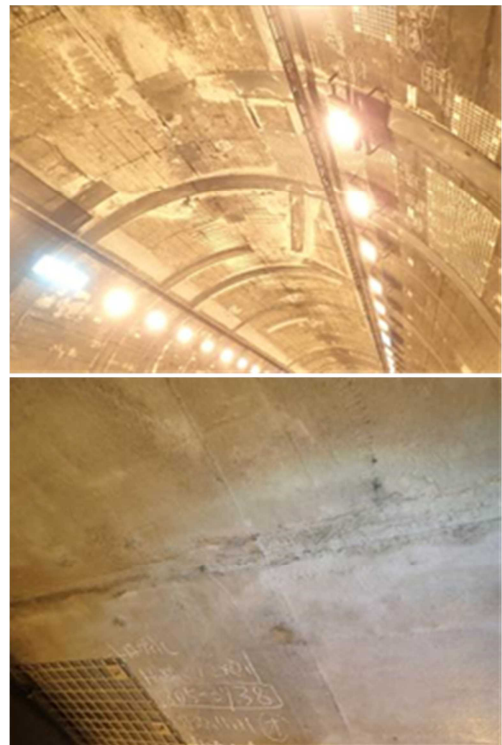
写真－4 覆工コンクリート損傷状況
