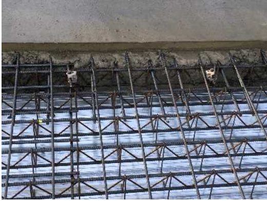
写真－10 打継部の状況
