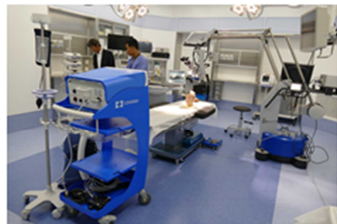
OPE 室 (日本業者施工)
