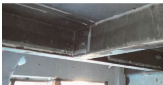
写真-2 600℃以下の高温履歴を受けた梁底の状況
