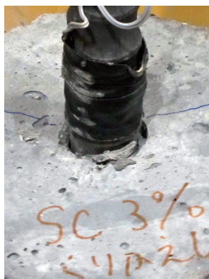
写真-1 割裂ひび割れ発生状況 (スチールチップ3%, D25, 繰り返し)
