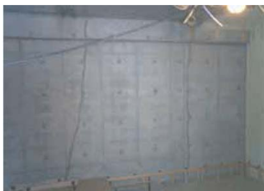
写真－４ 戸境壁に生じた収縮ひび割れの事例
