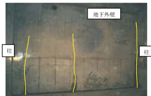
写真-1 地下外壁に生じたひび割れの状況
