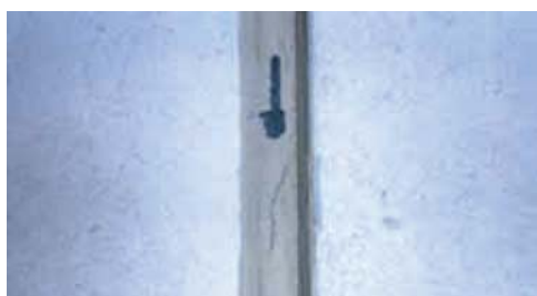
写真-3 誘発目地内に生じたひび割れ
