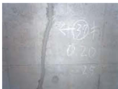
写真－５ エポキシ樹脂によるひび割れ処置事例
