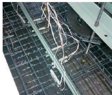
写真-2 埋め込みゲージ
