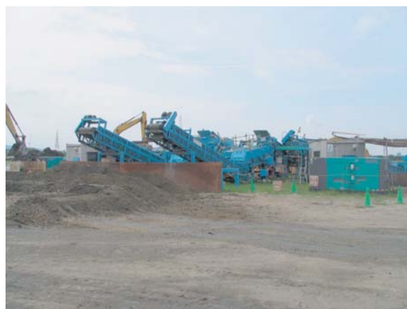
写真－1 混合プラント全景
