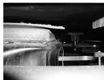
写真－2 No. 3 柱頭局部座屈状況
