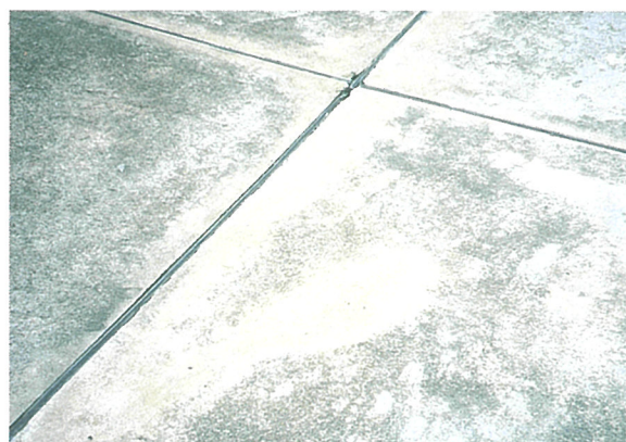
写真-1 床面の変色状況（ゾーンA）
