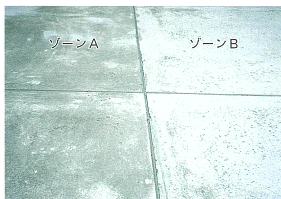
写真-2 床面の劣化状況の違い
