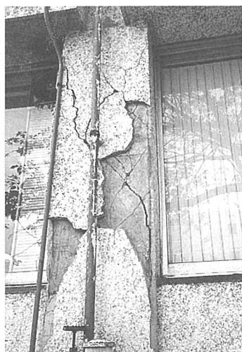
写真－1 A通り1階柱の損傷状況
