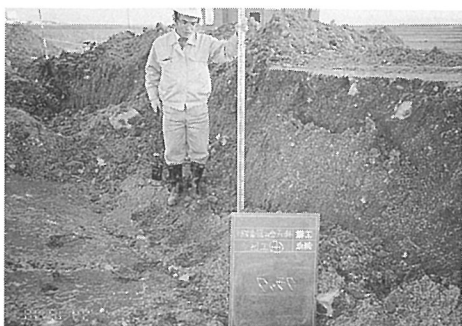
写真-5 盛土背面の滑落崖の状況（4工区）
