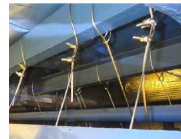
天井落下防止対策
