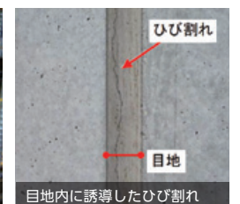
目地内に誘導したひび割れ
