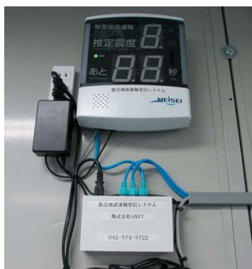
緊急地震速報システム(表示装置部)
