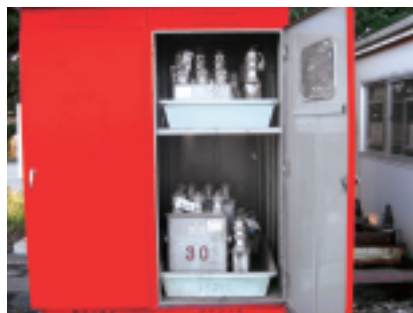
高圧コンデンサー保管状況
