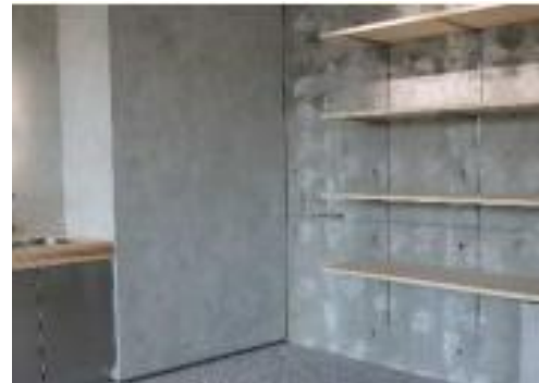
鉄筋コンクリートの耐久性を高めるための 表面処理を実施。
