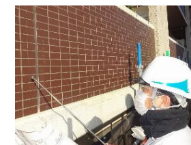
外壁タイルの長期点検制度
