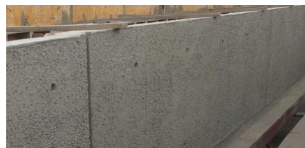
資源循環型コンクリートの施工状況 (コンクリート手摺)
